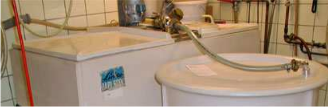
Foto 25: An der flexiblen Schlauchleitung können beliebig aufgestellte Behälter angeschlossen werden.
