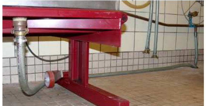
Foto 23: Saftleitung führt von der Presse in den Kellerfußboden.
