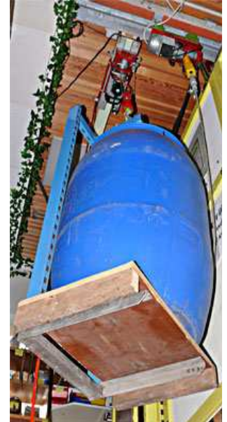
Foto 32: Mit der Galgengabel wird das 220 Ltr-Fass mit 150 Kg Gewicht von der Seilwinde aus dem Keller in das Erdgeschoss gehoben.
