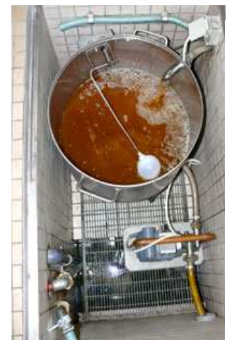
Foto 24: Saffthebeanlage unter der Kellersohle. Deckel des Behälters abgenommen. Unter der Roste die Tauchpumpe für Schmutzwasser.
